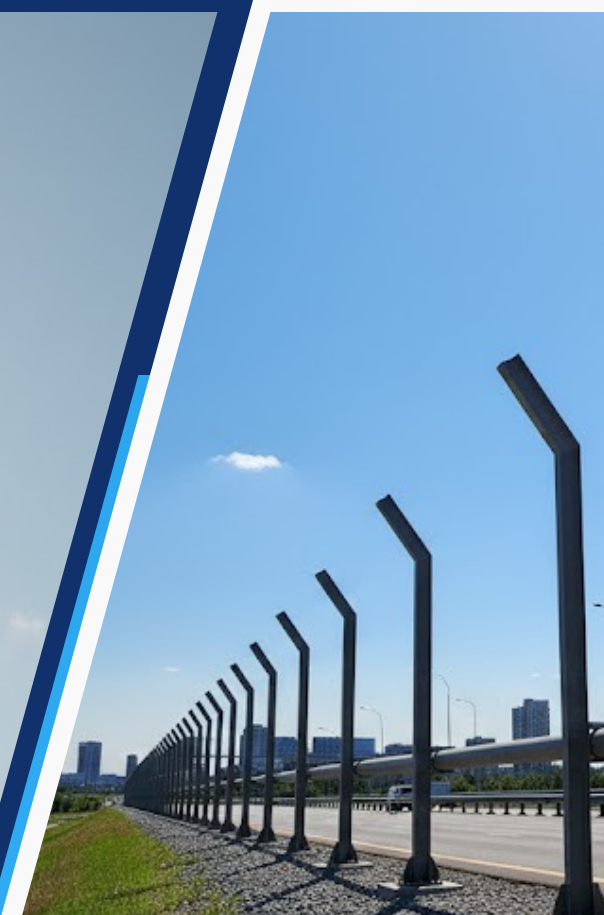
Стойки шумозащитных экранов
